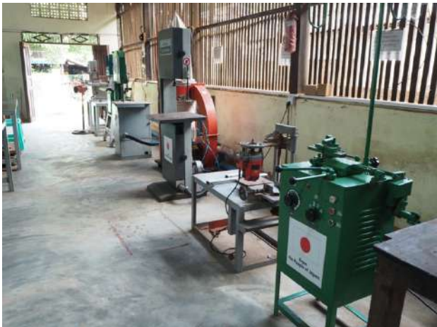
設置が完了した機械設備(2019年11月)
