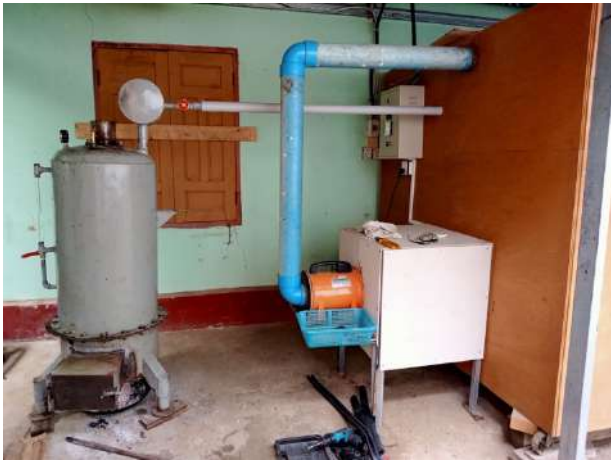
木材乾燥機へ接続されたボイラー
