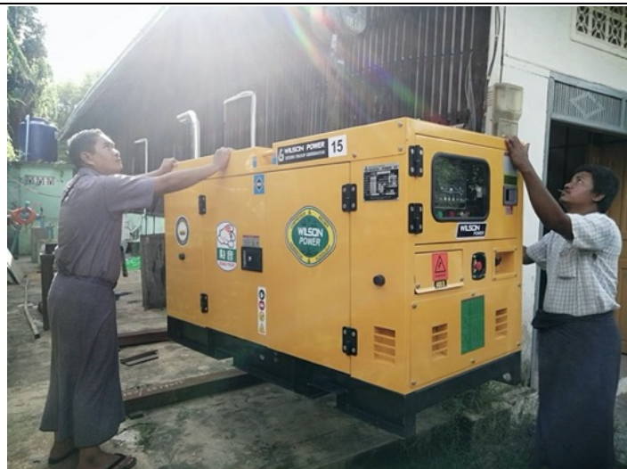
技術センターに納品される 15kVA 三相式の発電機
