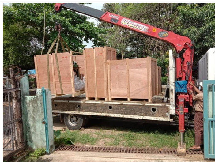
技術センターへ搬入される木工機械 5 台
